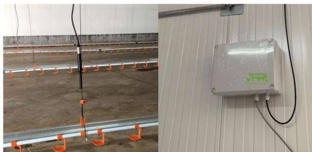
Mikrofon na pustej farmie i procesor zainstalowany na ścianie budynku farmy (dostarczone przez Cealvet)
