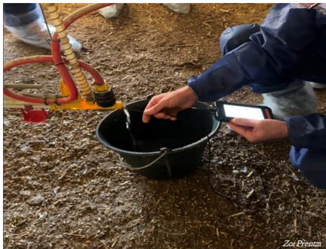
Monitorowanie tworzenia się biofilmu w instalacji wodnej przy użyciu endoskopu
