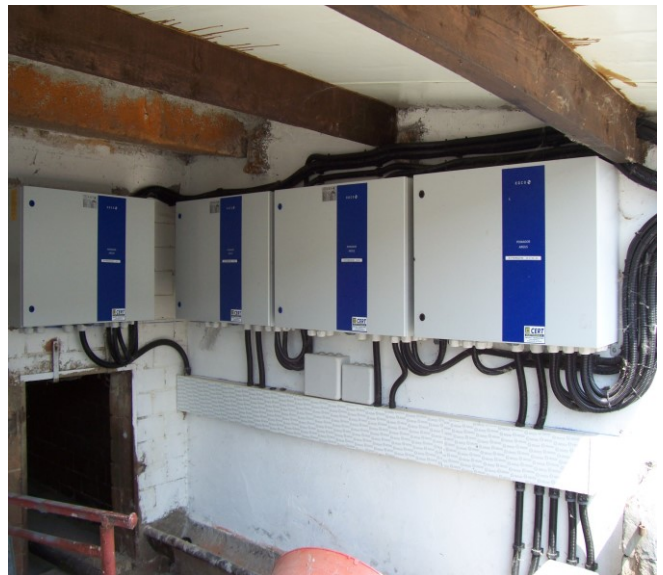
Abbildung 2 Kontrollbereich der Photovoltaikanlage
